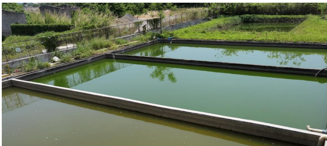
图 5.2-3 厂区污水处理池
