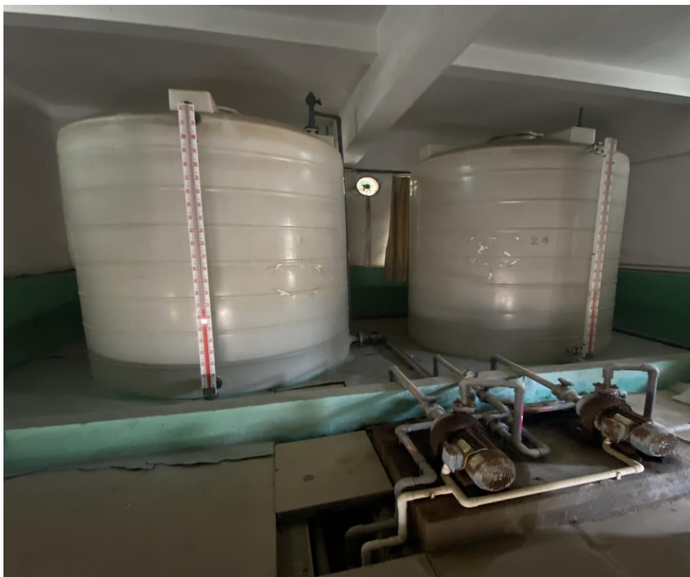
图 4.3-2 次氯酸钠储罐
