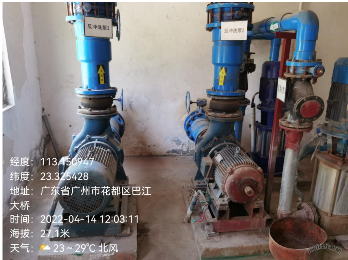
图 4.3-5 反冲洗泵、回用水泵
