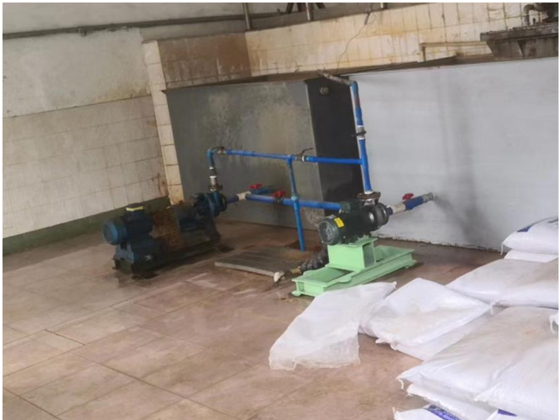
图 4.3-6 加药操作间传输泵
