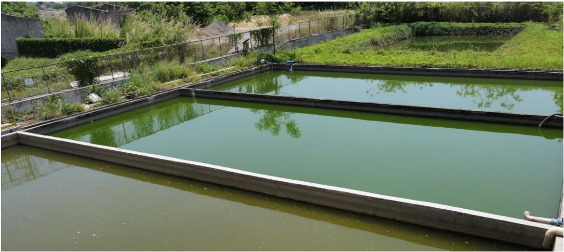
图 4.3-4 厂区污水处理池
