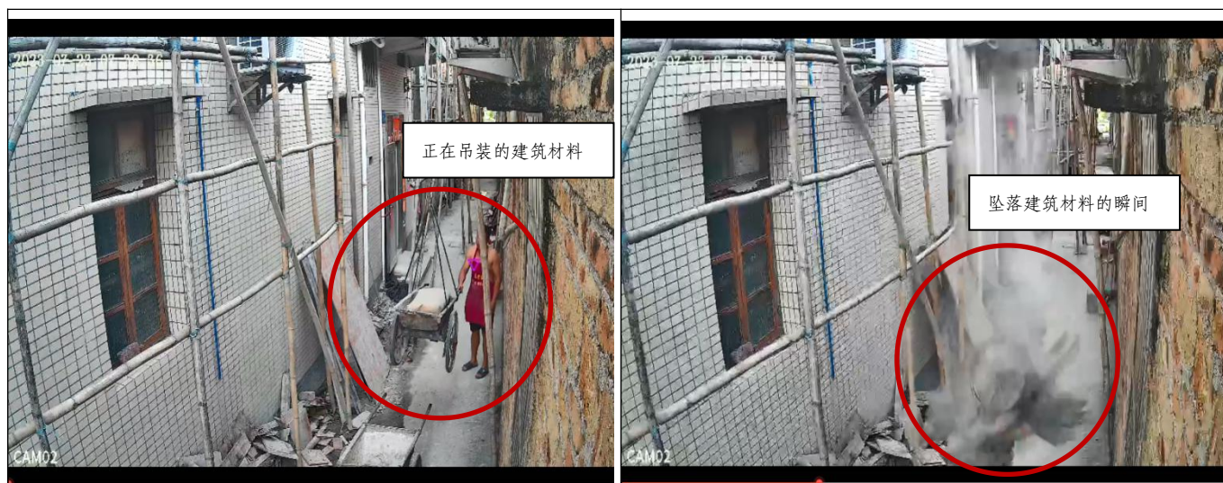
图 5 吊装建筑材料和建筑材料坠落情况
