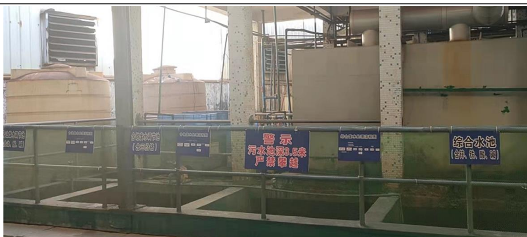
污水处理设施
